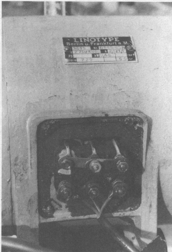
Drehstrom-Motoranschluss (in Sternschaltung, s.S. 61), Typenschild: 0,45 kW Leistung bei 720 U/min, wenn langsamer, weniger Leistung (s.S. 63).
